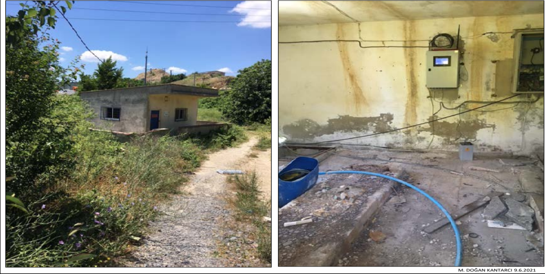
RESİM 1.LAHANA TEPE TAŞ OCAĞI DOĞUSU MURATBEY KÖYÜ SU DEPOSUNA KARST KAYNAĞI 2'DEN POMPA TRAFOSU (9.6.2021)
